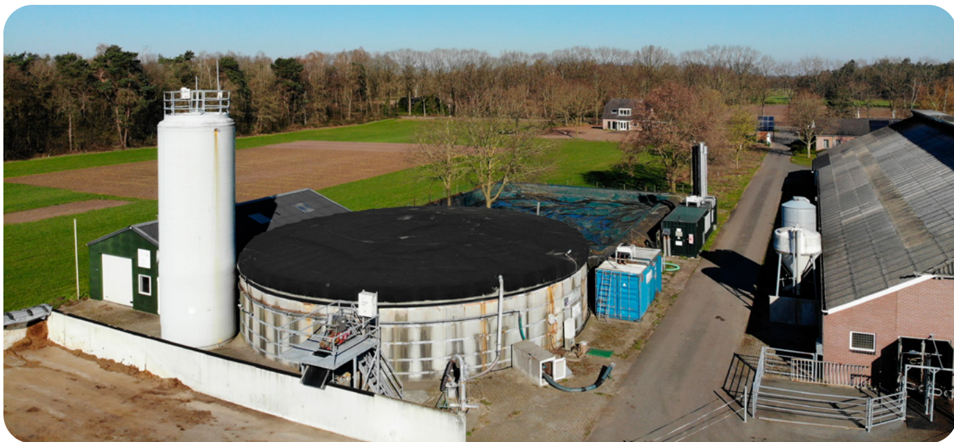
Biogasinstallatie op De Marke (2003 – 2019).
